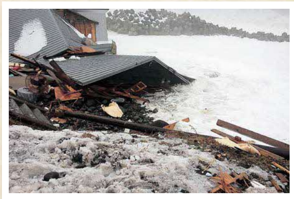
▲高潮の災害により多くの番屋が破損
