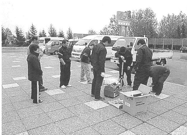
体験実習館前での発電機と照明器具の試験
