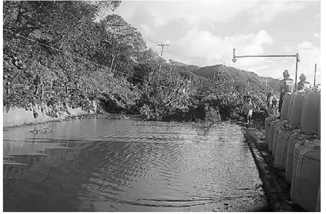
国道335号線礼文町ソスケ 土砂崩れ現場
