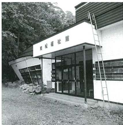
豪雪により倒壊した知松福祉館
