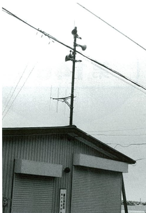
峯浜町消防サイレン
