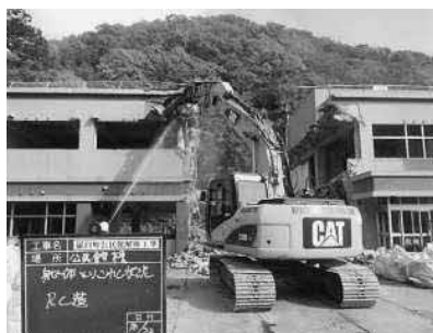
公民館解体工事 6,490万円 (耐震不足のため、公民館を廃止し解体されました。)
